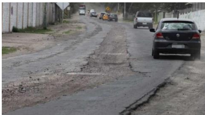
Figura 3. Deterioro de la Av. Ilaló por trabajos de alcantarillado Fuente: (Pallero, 2017)
