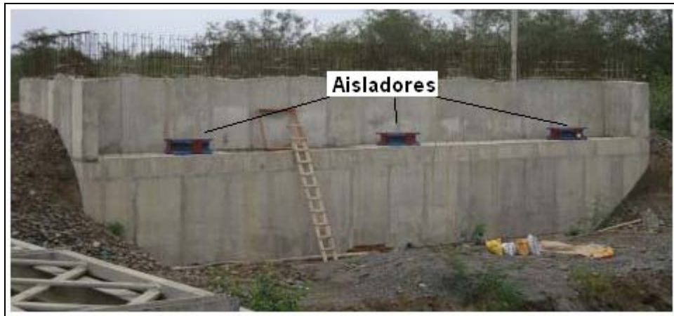
Figura 2.20: Estribo Tipo Cajón, Con aisladores FPS 3
