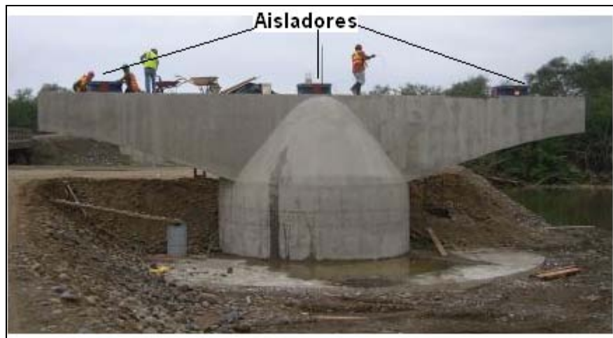
Figura 2.21: Pila central Puente Norte 1 con aisladores FPS.
