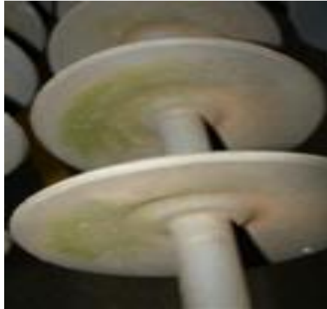
Figura 6. Aislador afectado por hongos.
