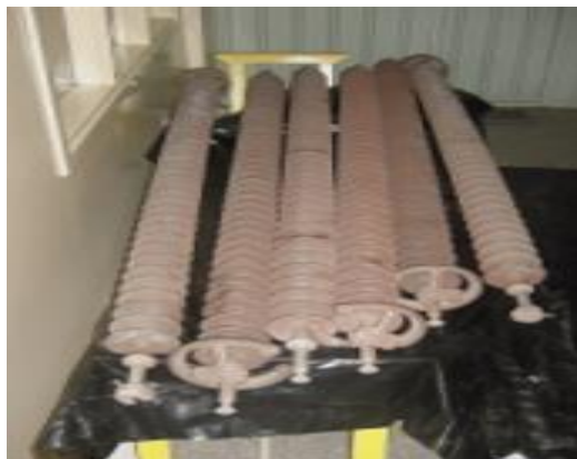
Figura 7. Aislador afectado por la contaminación industrial
