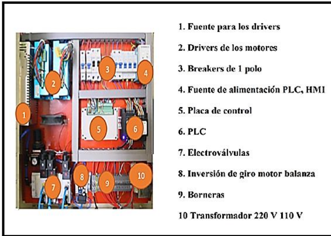
Figura 52. Distribución del tablero eléctrico
