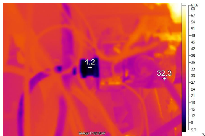
Figura 27. Medición termográfica enfriador combustible
