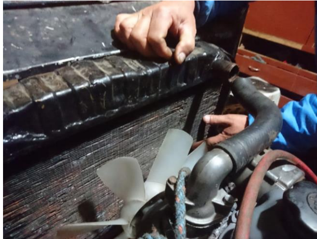
Figura 59. Radiador instalado con sus bases
