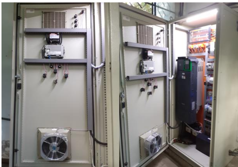
Figura 165. Parte posterior de la puerta del tablero
