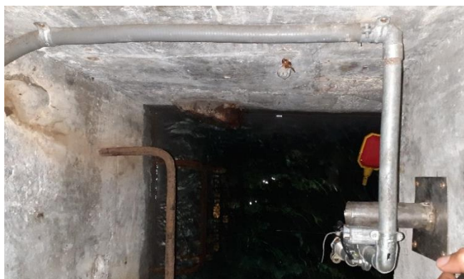
Figura 82. Instalación de la funda sellada del sensor Senix TSPC-30S1-485
