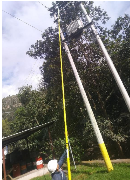
Figura 91. Corte de energía de transformador trifásico de 75 KVA.
