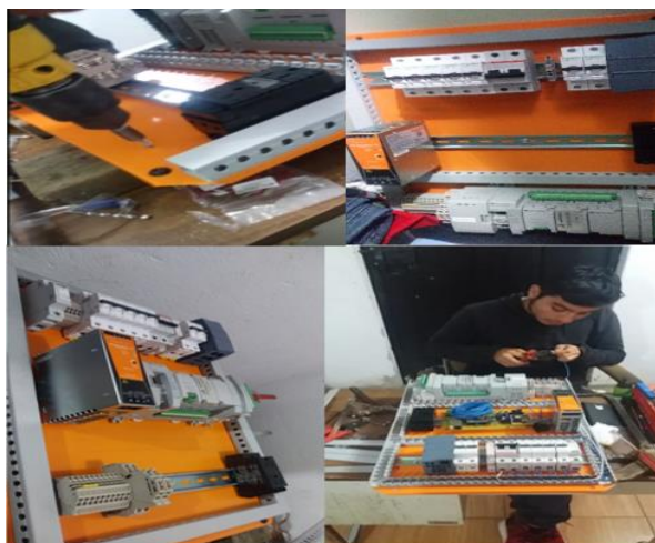
Figura 67. Montaje de elementos en el tablero de control del tanque de almacenamiento.
