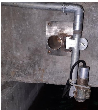
Figura 81. Instalación del sensor Senix TSPC-30S1-485.
