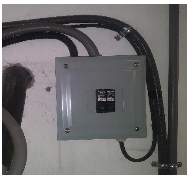
Figura 92. Caja de breakers servicios generales.
