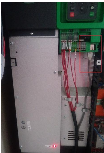
Figura 132. Cableado del puerto de comunicación del variador.
