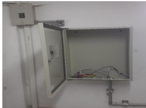
Figura 65. Cableado del sensor TSCPC-15S-485 hasta el tablero de control.
