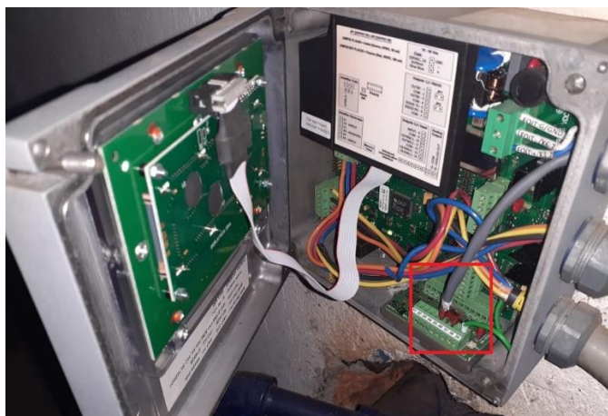
Figura 120. Conexión del cableado de comunicación del Badger Meter M2000.
