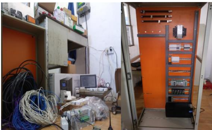
Figura 88. Montaje de elementos de control el tablero de la estación.
