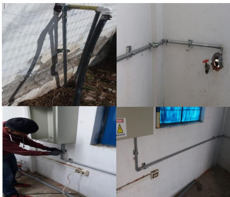
Figura 56. Tubería eléctrica del sensor de nivel hacia el tablero de control
