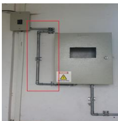
Figura 57. Tubería eléctrica para alimentación del UPS
