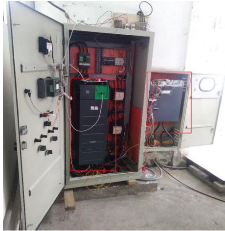
Figura 71. Tableros de variadores de frecuencia.
