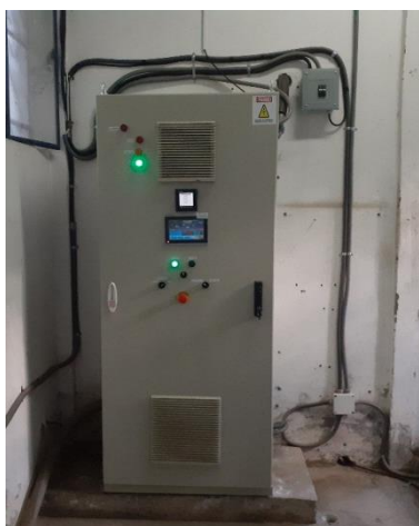
Figura 163. Tablero de fuerza y control en funcionamiento
