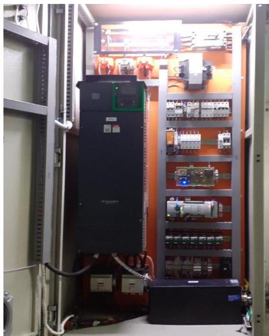
Figura 164. Componentes instalados en el doble fondo del tablero
