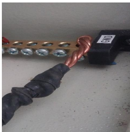
Figura 62. Conexión del cable de tierra con la barra de tierra.
