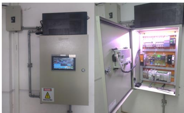
Figura 159. Tablero de control de la estación en funcionamiento
