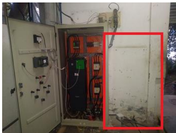
Figura 83. Estación de bombeo con el tablero desmontado.
