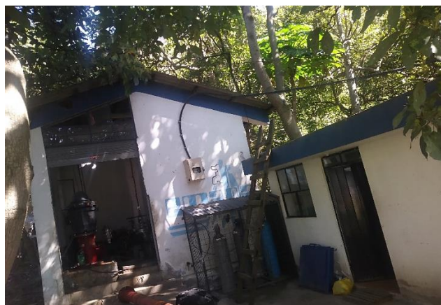
Figura 69. Estación de Bombeo La Península.
