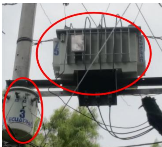
Figura 68. Transformadores de la estación de bombeo
