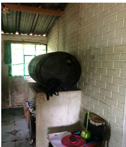
Figura 25. Almacenamiento de hidrocarburos en la infraestructura de almacenamiento final
