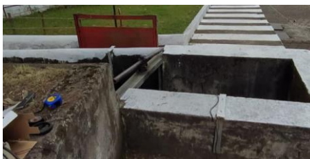
Canales a la salida de la central de generación 1
