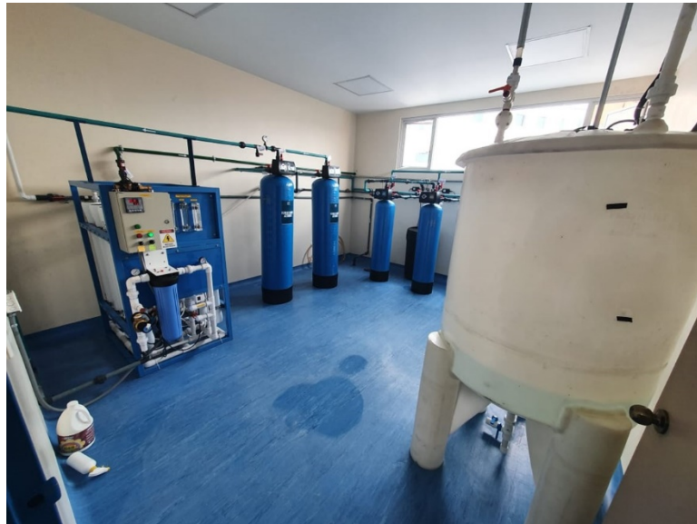
Planta de ósmosis y filtros de ablandamiento
