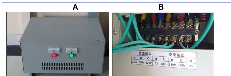
Figura 44 Transformador y sus características
