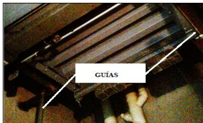
Figura 60 Guías de la cabina del elevador
