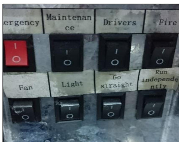
Figura 56 Tablero de control
