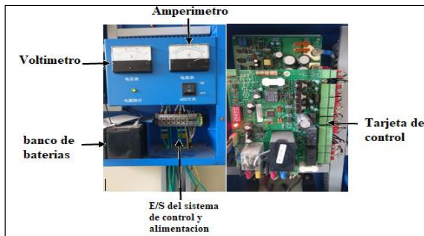
Figura 45 Sistema de control de seguridad
