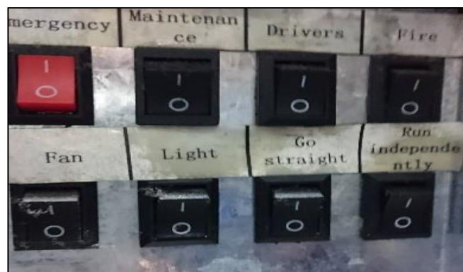
Figura 37 Tablero de control ubicado dentro de la cabina
