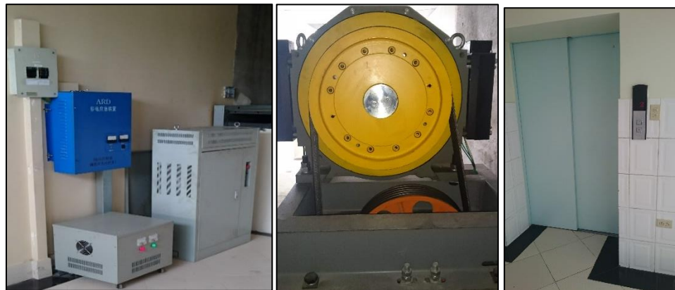
Figura 21 Sistema de elevación
