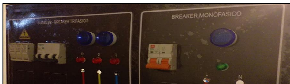
Figura 100. Indicadores de voltaje, corriente y dispositivos de protección.
