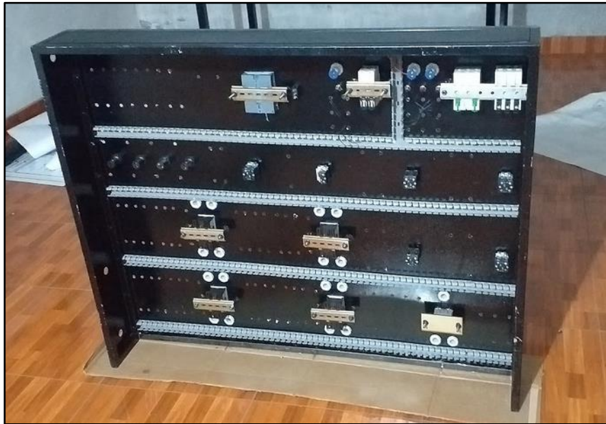
Figura 106. Vista posterior de los equipos eléctricos
