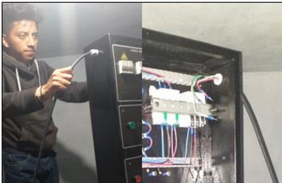
Figura 124. Conexión de la alimentación principal del banco de pruebas
