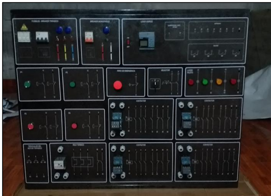
Figura 105. Vista frontal de la distribución de los equipos eléctricos
