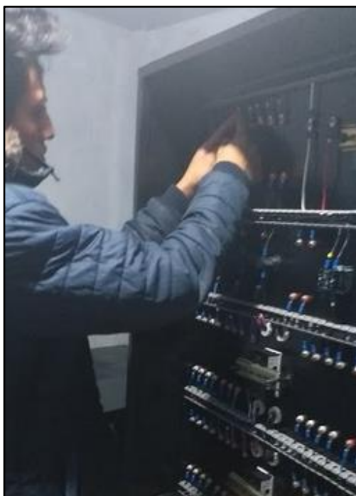
Figura 126. Etiquetado de conductores
