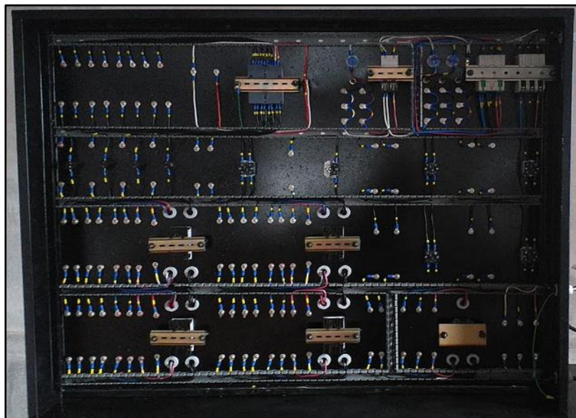
Figura 128. Vista posterior de cables etiquetados finalizado
