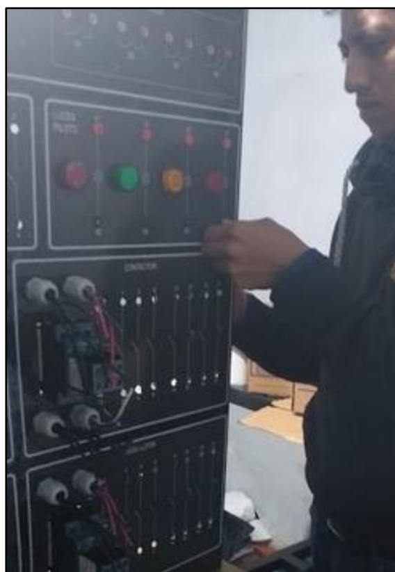
Figura 115. Ubicación de terminales jacks
