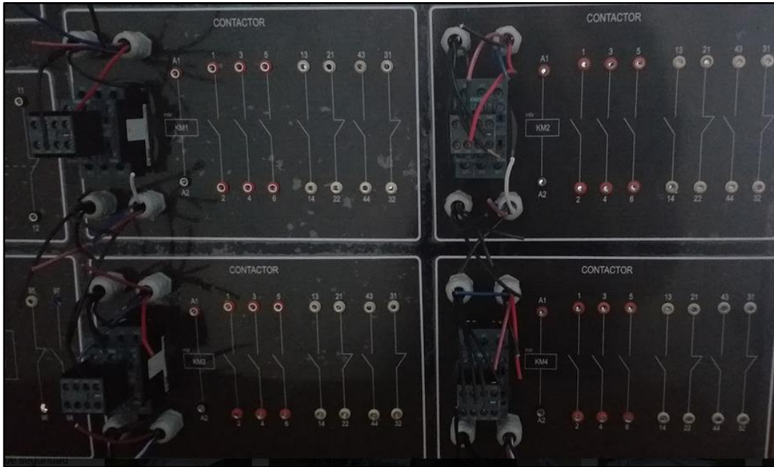
Figura 116. terminales jacks ubicados en el tablero
