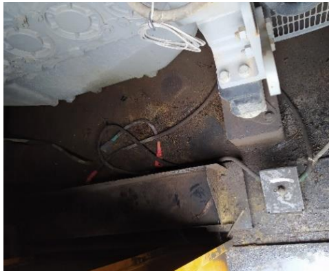
Interruptor de batería
