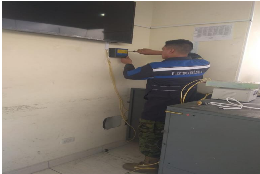
Figura 43. Instalación de Switch de transferencia automática (ATS)
