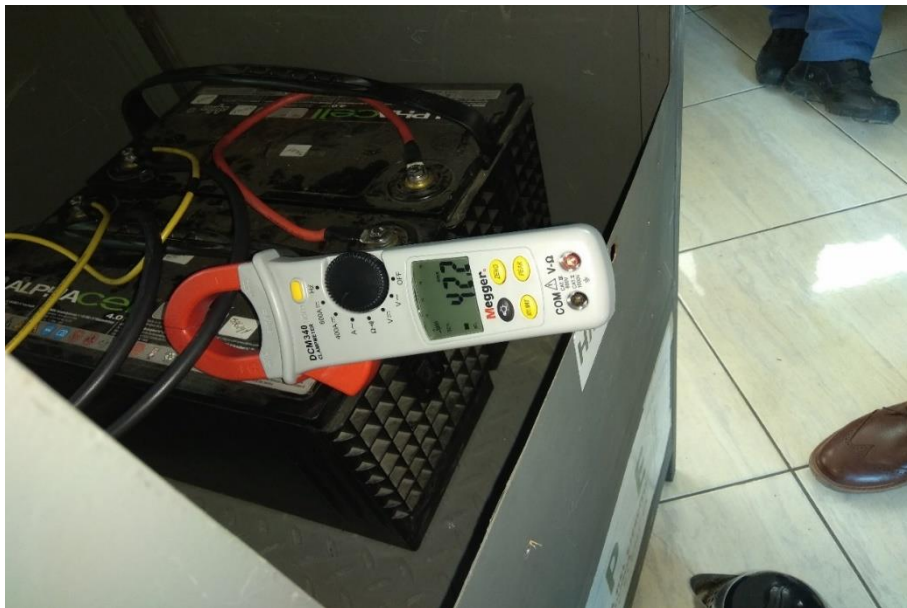
Figura 42. Verificación de paso de corriente
