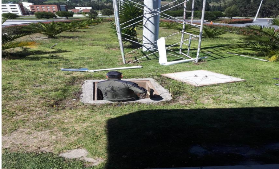
Figura 41. Cableado del generador hasta los equipos de control
