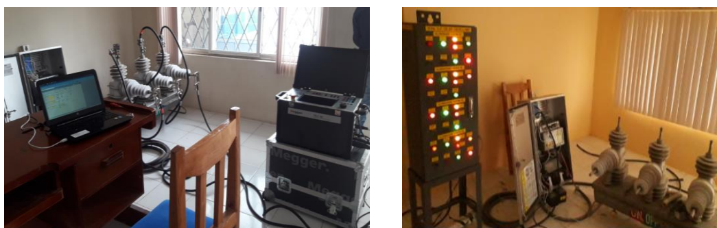
Figura 65 Pruebas eléctricas de banco
