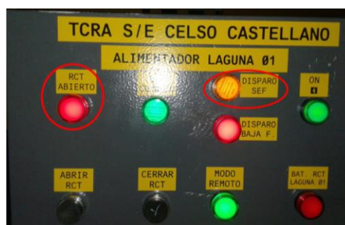
Figura 92 Pilotos de estado de falla de tablero TCRA
