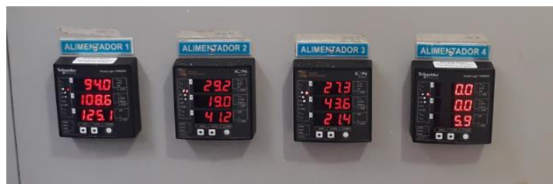
Figura 31 Medidores de alimentadores
