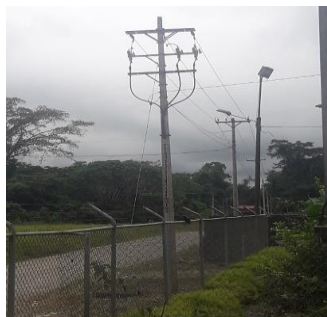
Figura 32 Salida de 13. KV de la Subestación
