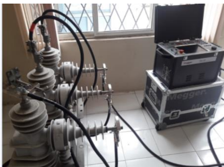
Figura 101 Pruebas de inyección de corriente primaria
