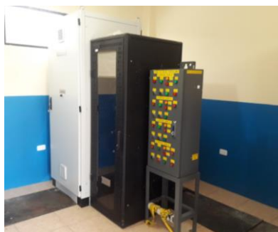
Figura 67 Ubicación de tablero TCRA
