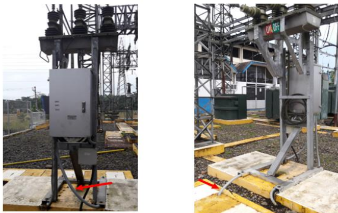
Figura 68 Acople de tubería a RCT de Alimentador Laguna 02
