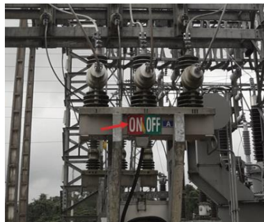
Figura 88 Rct Alimentador Laguna 03
