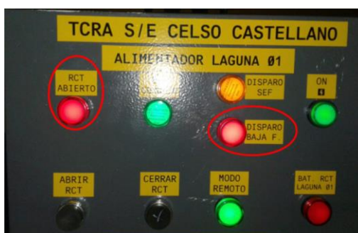
Figura 93 Pilotos de estado de falla de tablero TCRA
