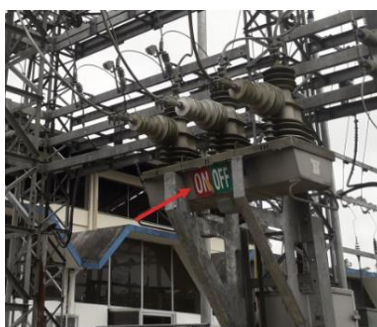
Figura 86 Rct Alimentador Laguna 01
