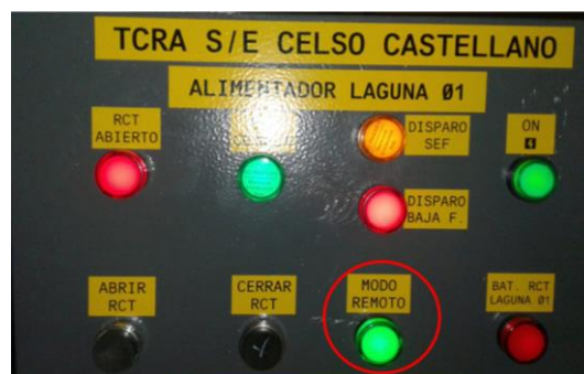
Figura 95 Operación remota de tablero TCRA
