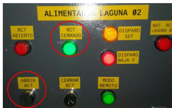
Figura 97 Estado de RCT en bahía 13.8KV Laguna 02
