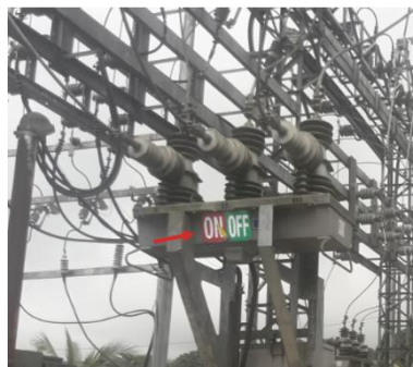
Figura 89 Rct Alimentador Laguna 04
