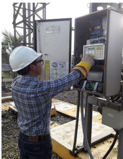
Figura 105 Verificación de estado de RCTS
