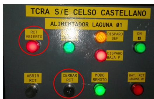
Figura 96 Estado de apertura de RCT en bahía 13.8KV
