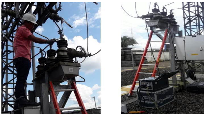
Figura 90 Simulación de fallas con equipo TRAX-Megger
