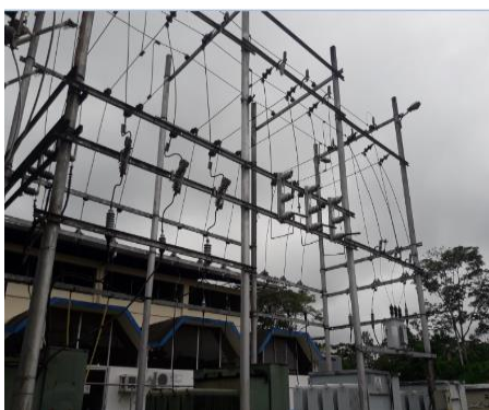
Figura 28. Cuadros de 13.8 KV de CELEC Ep
