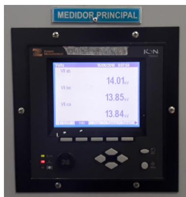
Figura 30. Medidor de barra principal de 13.8 KV
