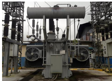
Figura 26 Trafo de potencial S/E Celso Castellano
