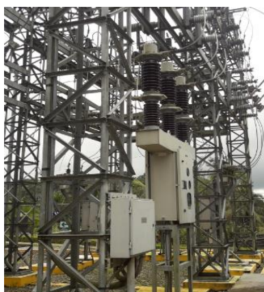
Figura 39. Disyuntor de 13.8 KV
