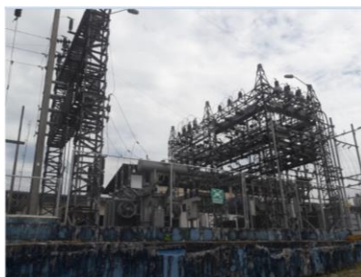
Figura 66 Subestación Eléctrica Celso Castellano
