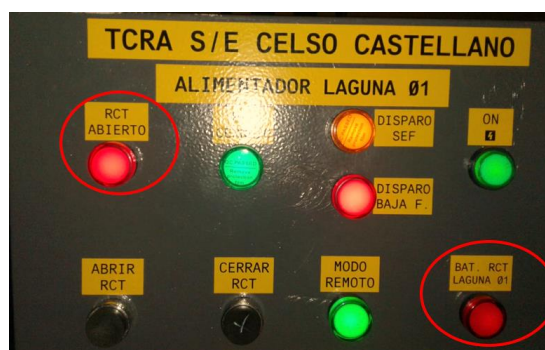
Figura 94 Falla de batería de controlador ADVc en TCRA
