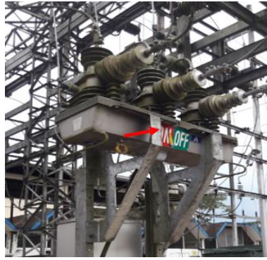
Figura 87 Rct Alimentador Laguna 02
