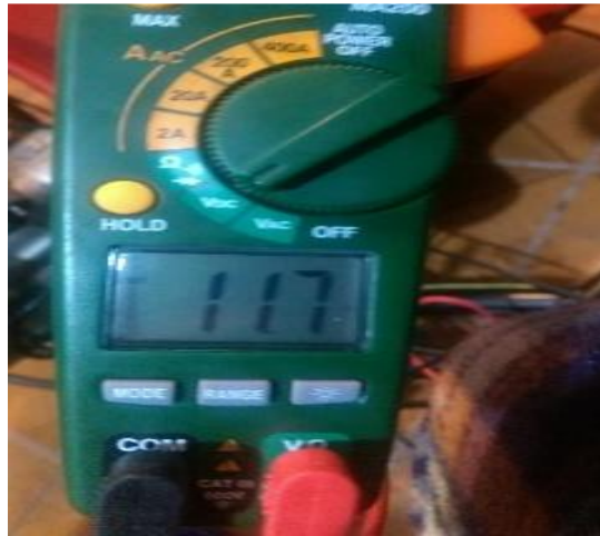
Figura 55 Medición de voltaje al CDI
