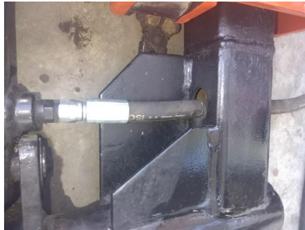
Figura 35. Instalación de la manguera hidráulica que llega desde la unidad de potencia
