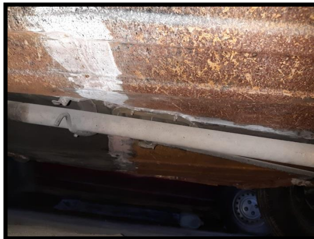
Figura 24. Presencia De Oxido
