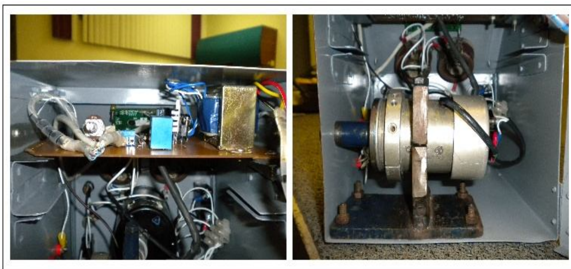
Fig. 3.28 Elementos en la placa de baquelita y colocados en la estructura
