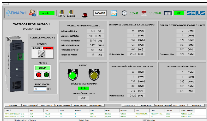
Pantalla variador de velocidad - SCADA Caranqui
