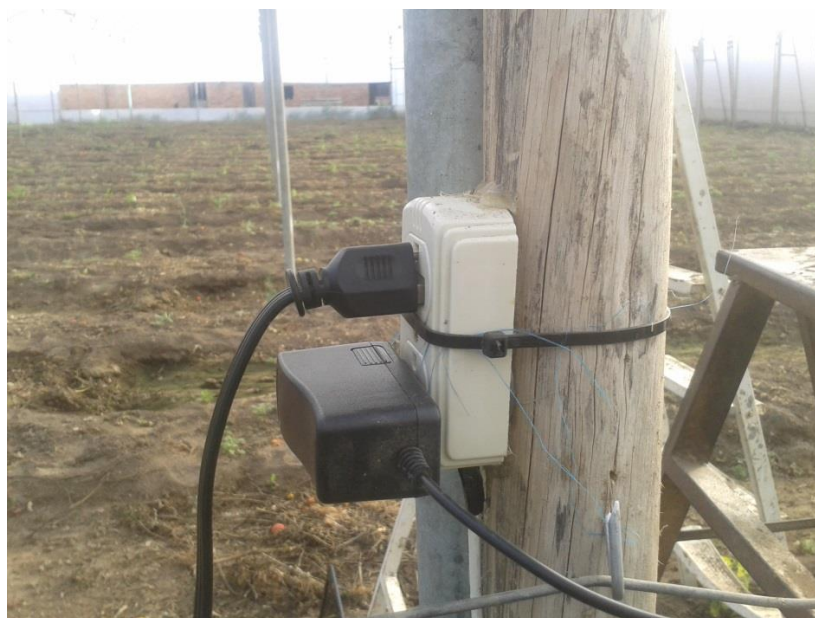
Figura 60. Tomacorriente instalado dentro del invernadero.
