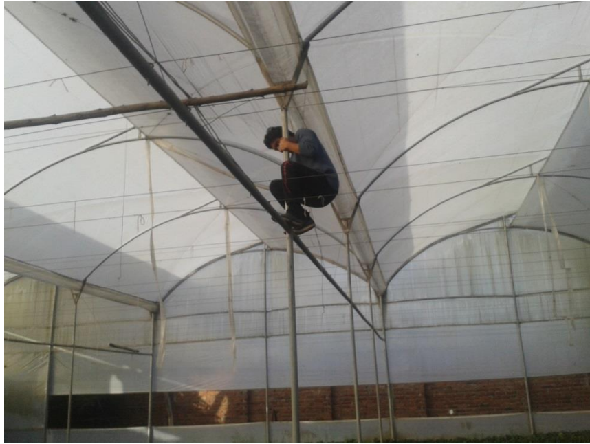
Figura 66. Instalación de los sensores DHT22.
