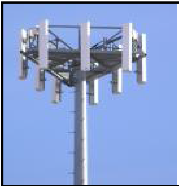
Figura 4 Torre de transmisión
