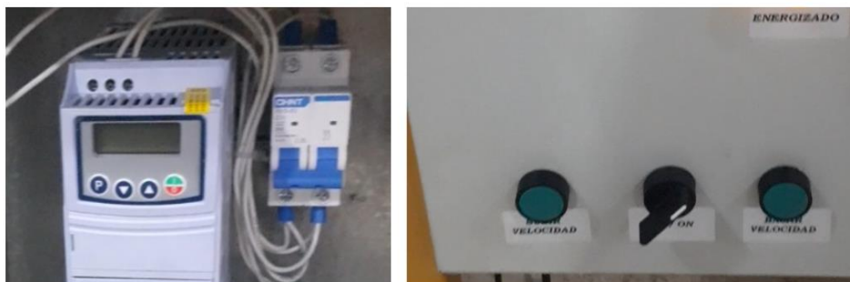
Figura 43 Mandos de control del banco en la posición off
