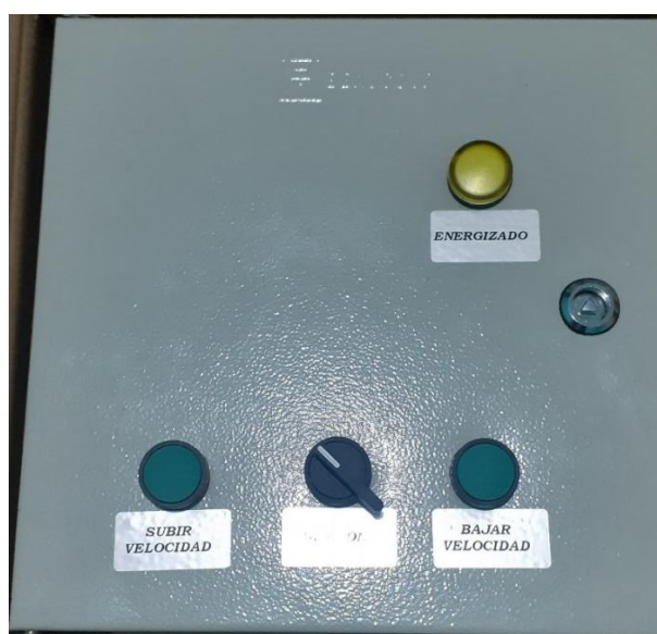
Figura 33 Panel de control del banco
