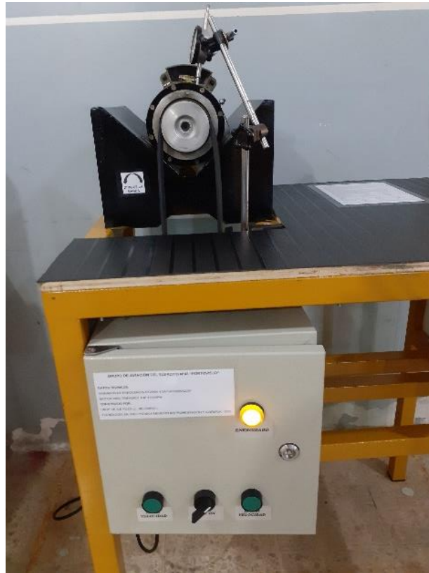
Figura 47 Tablero de control energizado
