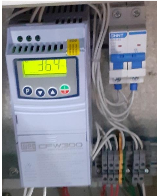
Figura 32 Variador de frecuencia encendido
