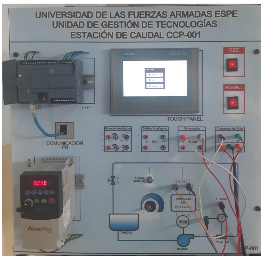
Figura 16. Estación de caudal CPP-001.
