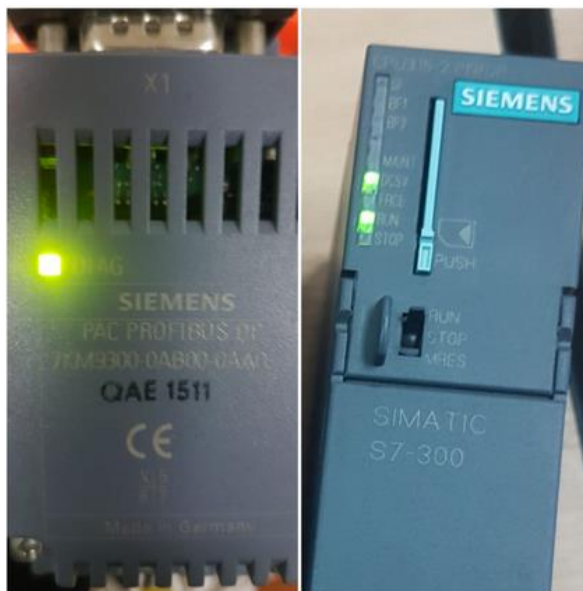
Figura 66. Verificación de comunicación PROFIBUS
