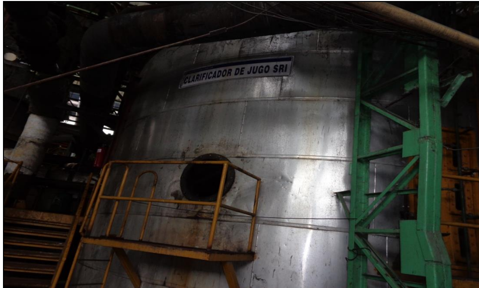
Figura 3.3 Área de Clarificadores Fuente: Investigación de campo Elaborado por: Katty Zabala
