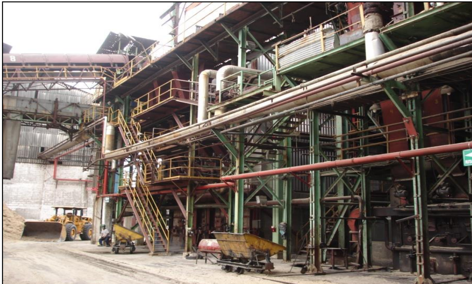
Figura 3.10 Área de Calderas Fuente: Investigación de campo Elaborado por: Katty Zabala
