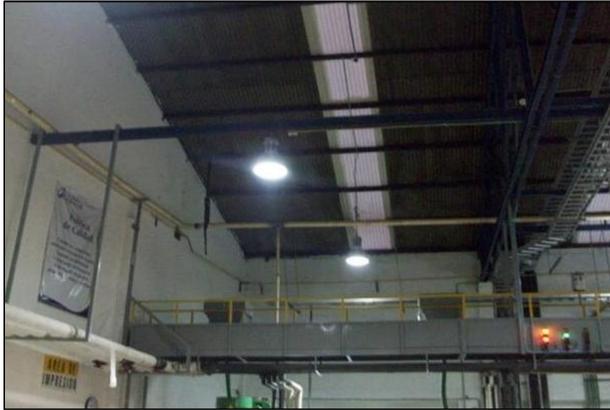
Figura 2.4 Iluminación en áreas industriales Fuente: http://www.iluminet.com.mx/iluminacion/
