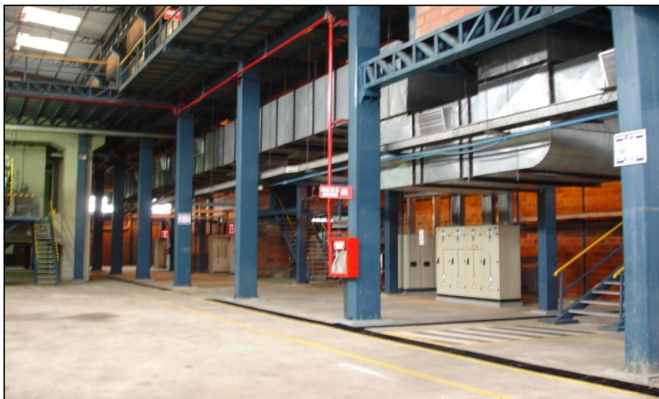
Figura 3.11 Área de Cogeneración Fuente: Investigación de campo Elaborado por: Katty Zabala
