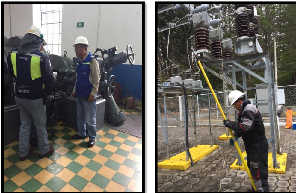
Figura 41 Puesto de trabajo operador Illuchi I
