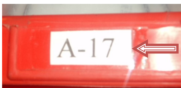
Figura N° 39. Identificación de Codificación para el Cuarto Caliente
