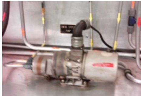
Fig.2.6: Bomba de emergencia Fuente: Investigación de campo
