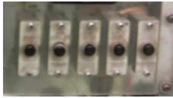
Fig. 2.46: Interruptores automáticos Fuente: Investigación de campo
