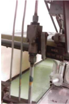
Fig. 2.16: Válvula manual de corte Fuente: Investigación de campo
