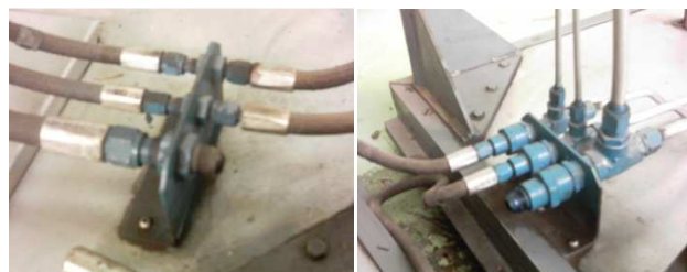
Fig. 3.5: Fittings desconectados Fuente: Investigación de campo
