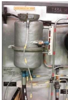
Fig. 2.2: Reservorio hidráulico principal Fuente: Investigación de campo
