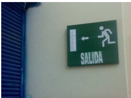
Letrero de salida de emergencia
