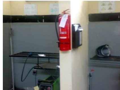
Extintor de fuego
