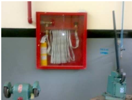
Manguera contra incendios
