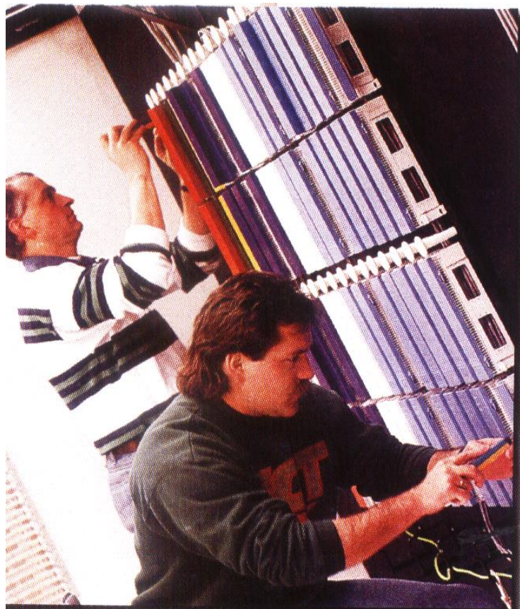
Fig. 7.5. Vista de un cuarto de telecomunicaciones
