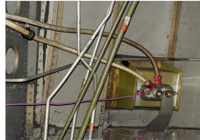
Conexión Planta Externa
