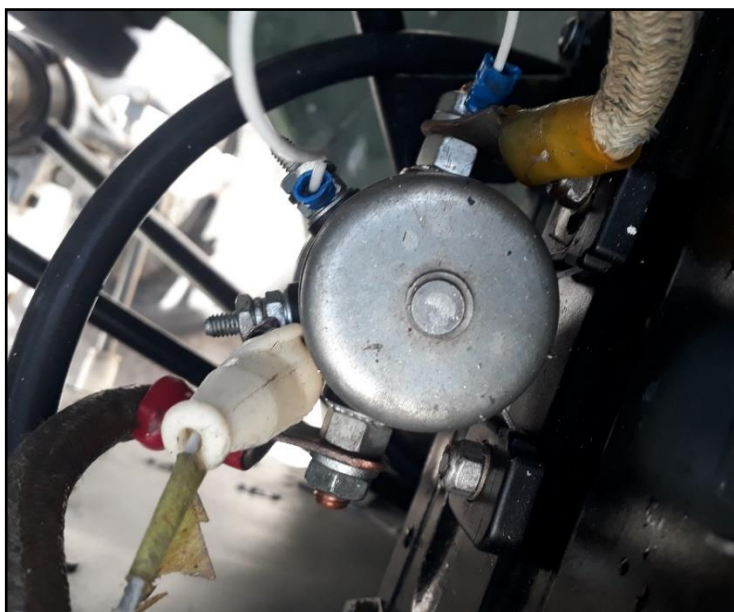
Figura 21 Contactor de la batería
