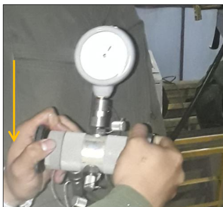
Figura 67 Purga de Aire
