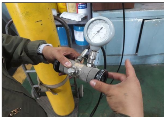
Figura 74 Manipulación de las llaves de Llenado de Nitrógeno
