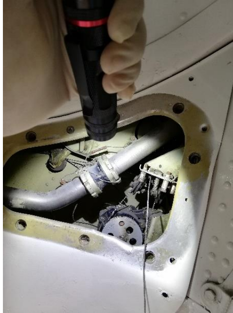
Figura 80 Inspección de cañería y cables
