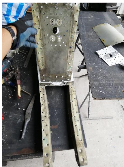
Figura 49 Piel con corrosión y daño estructural
