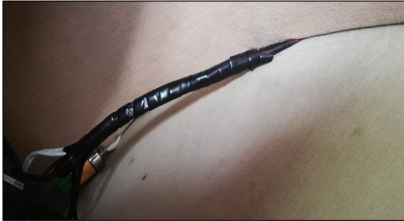
Figura 23. Protección de cableado.
