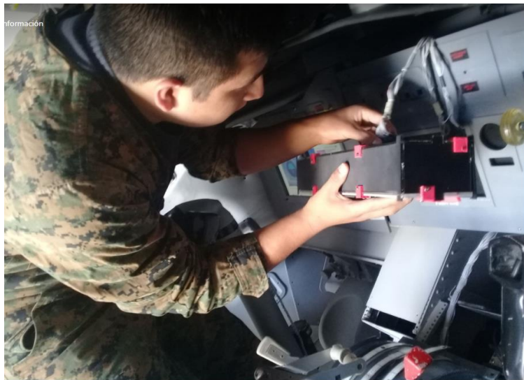
Figura 47 Revisión del estado del panel AFDS en la cabina B737
