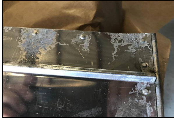
Figura 19. Corrosión en la estructura
