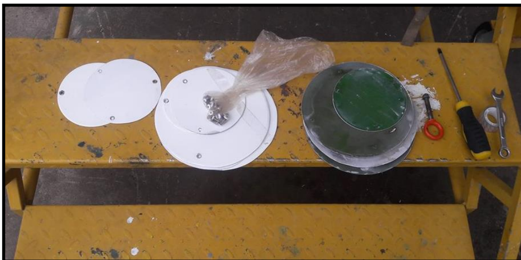
Figura 28 Tapas de inspección removidas.
