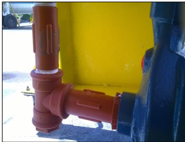
Figura 52 Figura 1 Tubería de succión de agua
