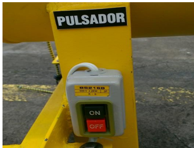
Figura 66 Encendido de la Bomba
