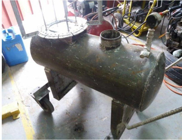
Figura 36 Pintura removida del tanque
