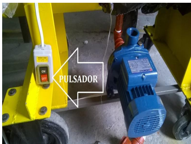
Figura 56 Ubicación del cableado y Pulsador
