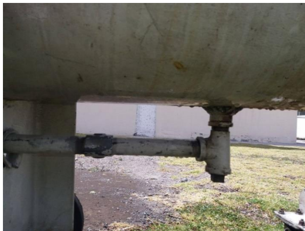
Figura 30 Tubería de salida de agua del tanque
