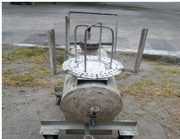
Figura 33 Tanque con removedor
