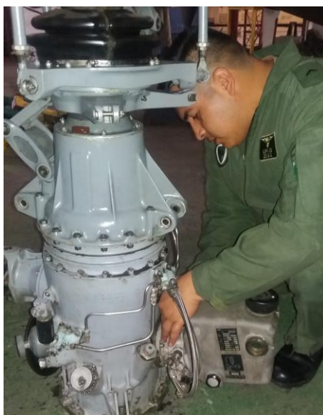
Figura 51 Montaje de los elementos del sistema Hidráulico a la caja de transmisión principal
