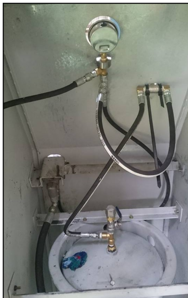
Figura 43: Circuito hidráulico ensamblado
