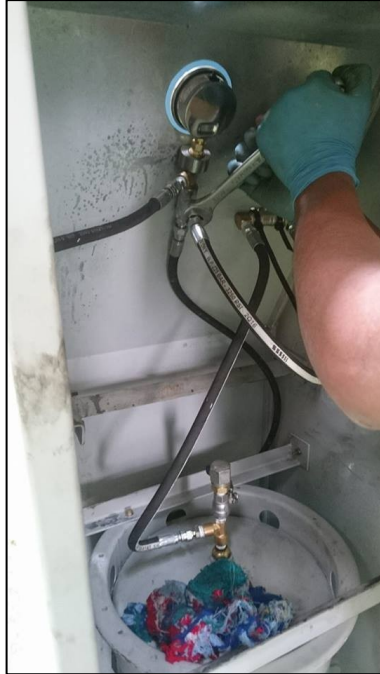
Figura 42: Ensamblaje del manómetro y llave de paso
