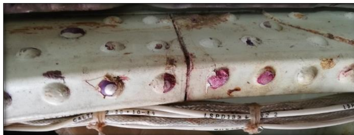
Figura 30. Corrosión en elementos de sujeción.
