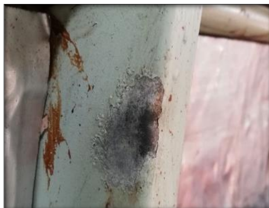
Figura 31. Propagación de corrosión
