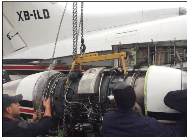
Figura 26. Elevación del motor.
