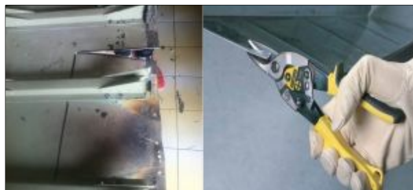
Figura 52 Corte del segmento de lámina inferior en mal estado
