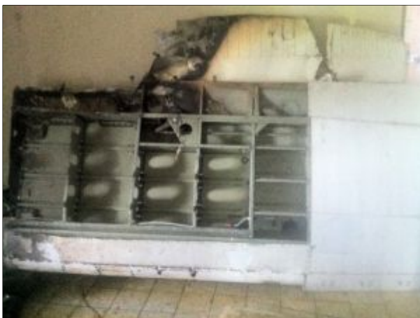
Figura 42 Identificación de daños
