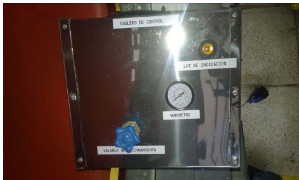
Figura 3.8. Caja de control
