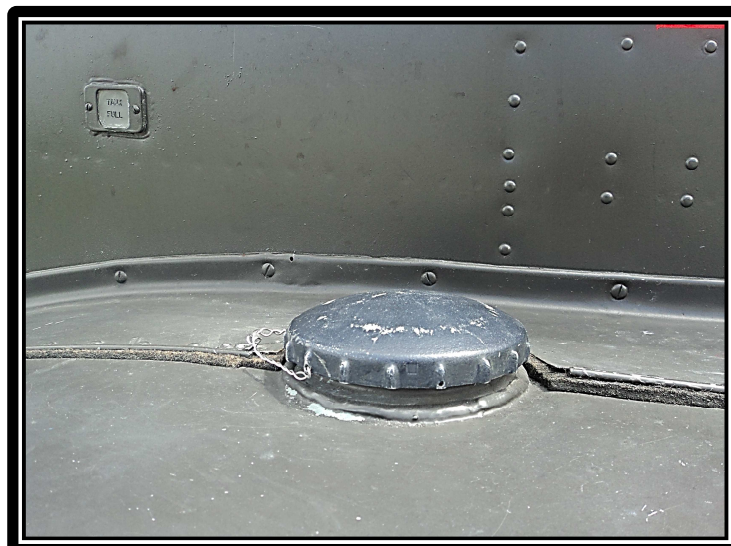
Figura 2. 41: Tapa del punto de repostado de combustible
