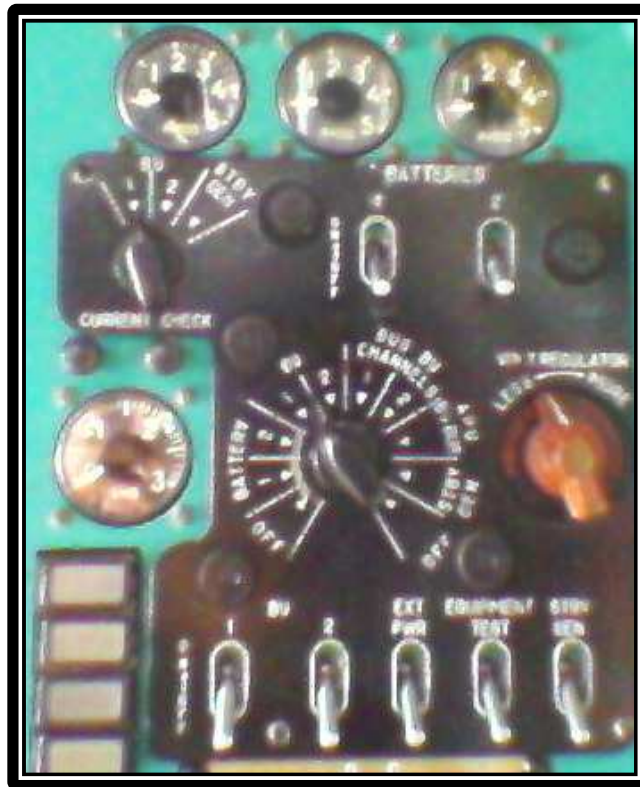
Figura 2. 37: Panel de control eléctrico
