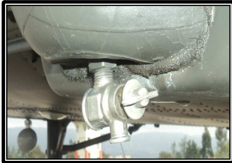
Figura 2. 43: Válvula manual de drene de los tanques externos
