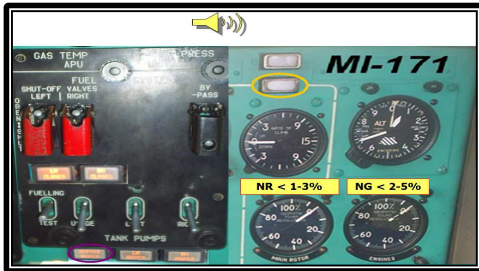
Figura 2. 44: Falla de la bomba booster
