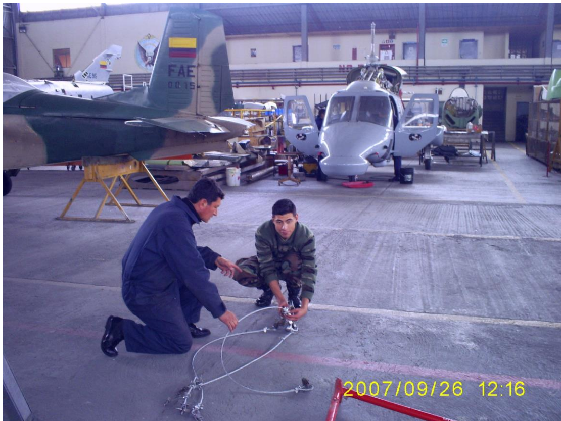
Fig. 4.1 En esta fotografía se muestra al personal de mantenimiento realizando el acoplamiento de los cables al gancho que sostiene al conjunto de cables de acero.
