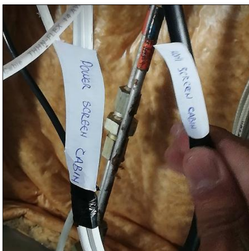
Figura 60. Señalización del cable
