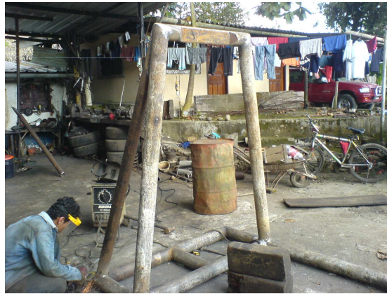
Fig. 3.11 Ensamblaje de la estructura para los puntos fijos con la base Fuente: Taller industrial “Izurieta”
